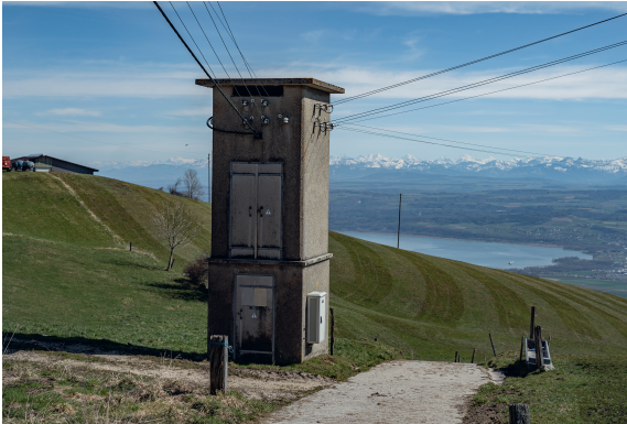
Figure 2 Le poste de boucle de réseau de distribution secondaire de Sainte-Croix.
