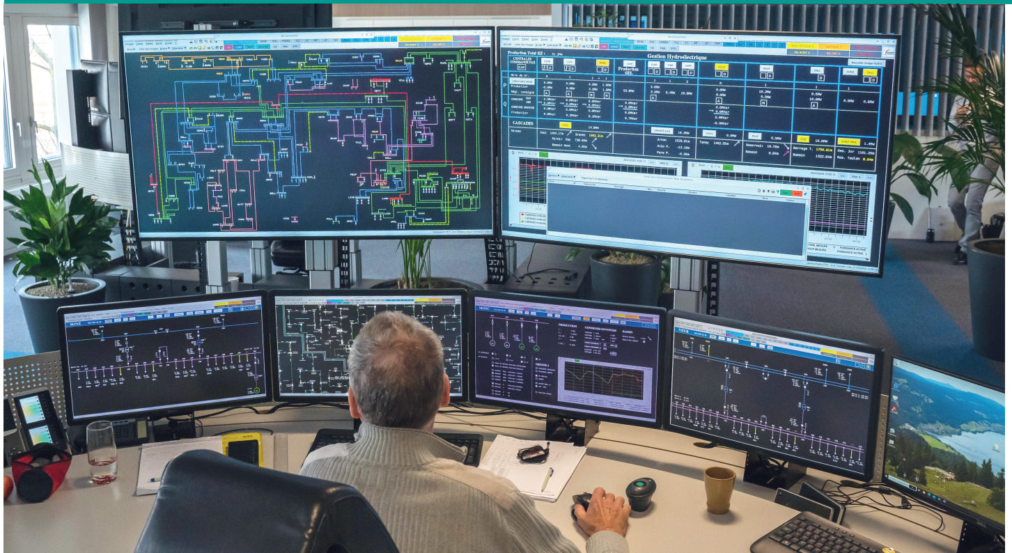
Le centre de contrôle de Romande Energie.
