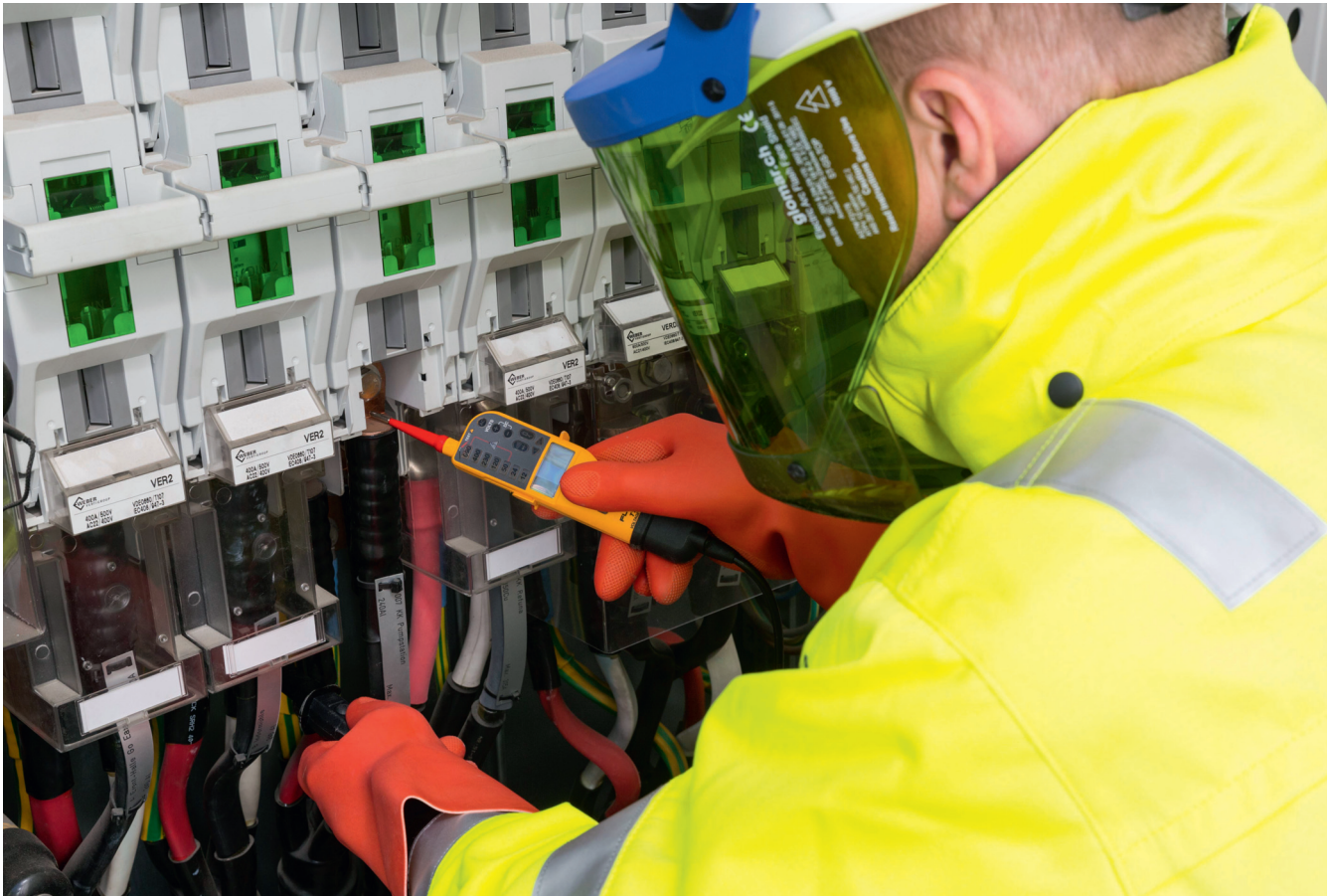
Messung bei einer Verteilung ohne Berührungsschutz mit PSA.
