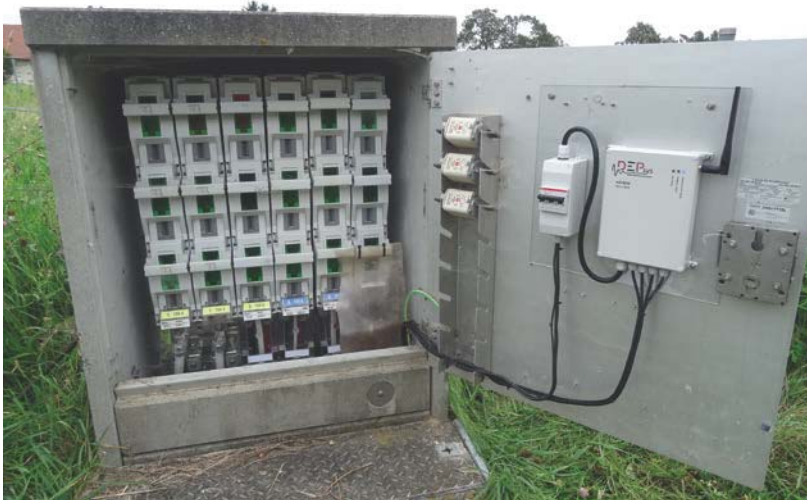
Figure 2 Armoire de distribution avec un module GridEye.
