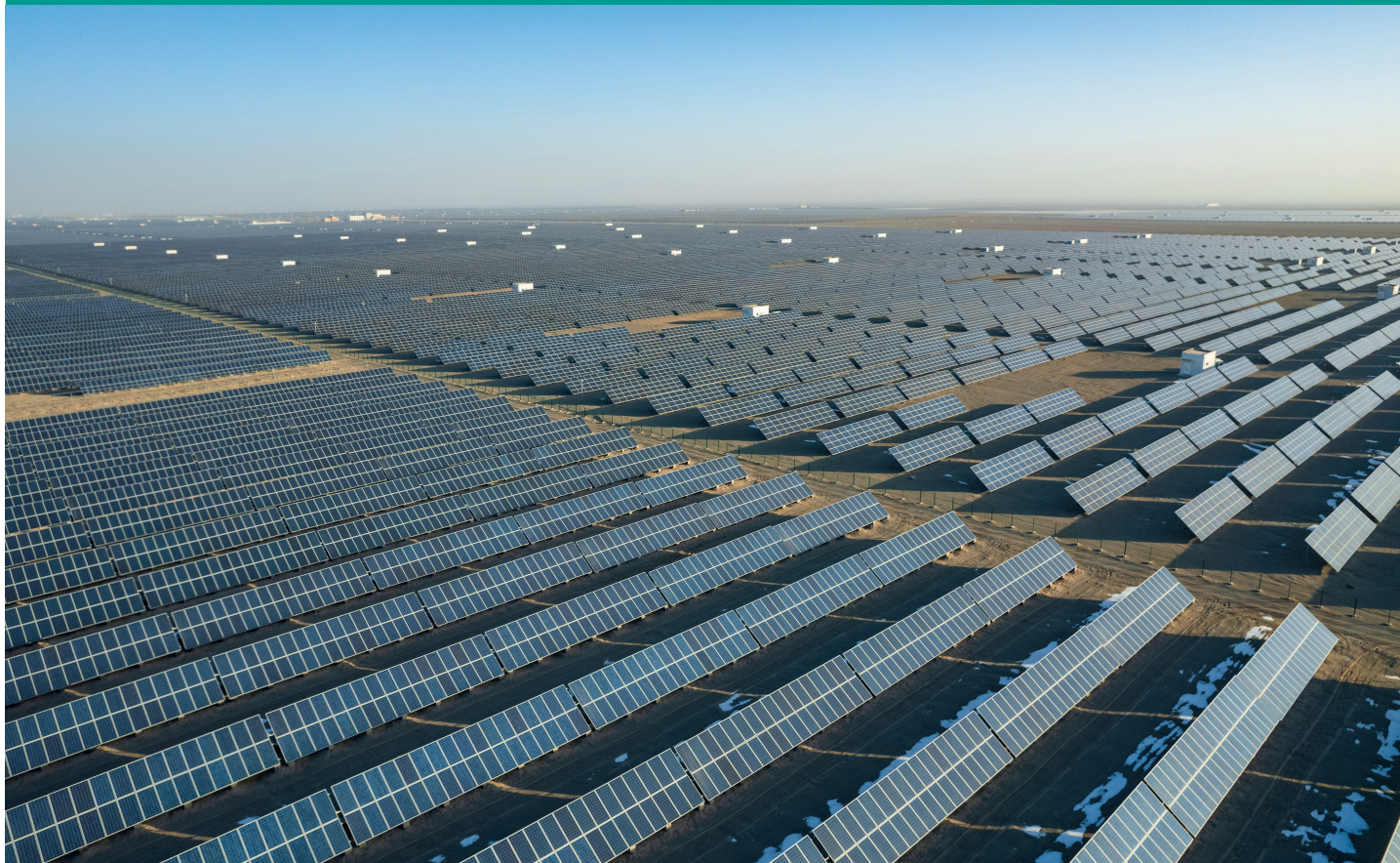
Centrale photovoltaïque à Dunhuang, en Chine.
