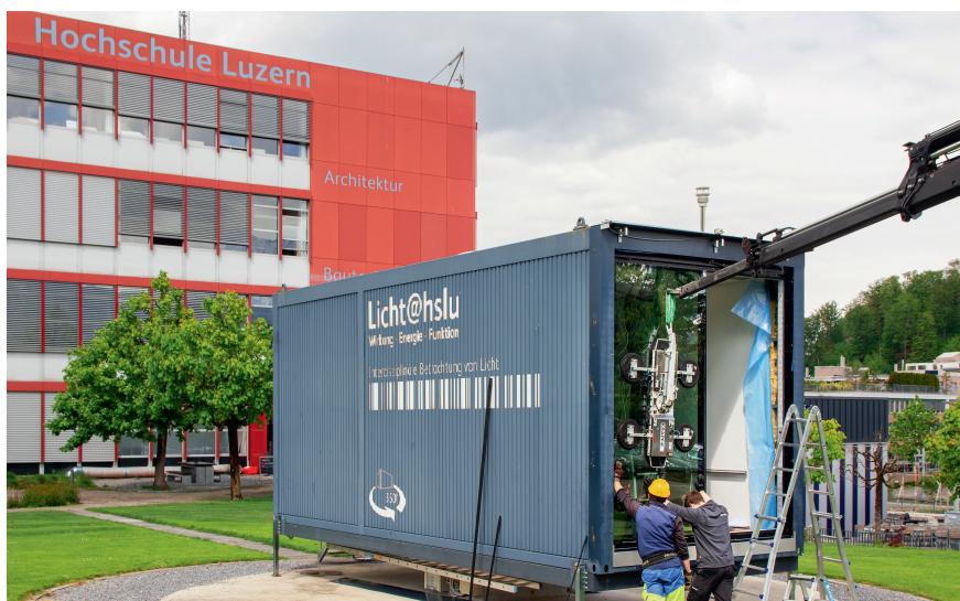
Figure 1 Le container de mesure de la lumière sur le campus de la HSLU, à Horw, lors de l'installation du vitrage électrochrome.
